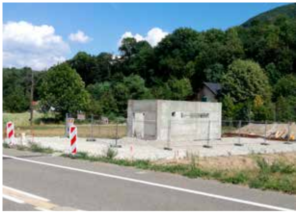
Une nouvelle station de pompage
